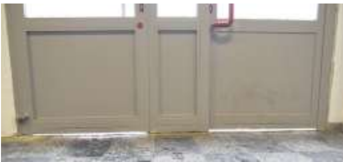
Durch die Spalte unter den T ren der Elmshorner Bahnho shalle pfeift der Wind. Die Bahnho smission kann nicht dagegen anheizen. Foto: Frank
